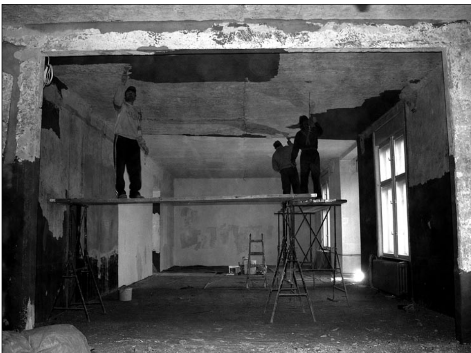
Felújítási munkálatok a nagy kiállítóteremben Inner reconstruction in one of the exhibition halls
